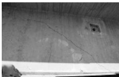
Fot. 2. Zarysowania belki T Photo 2. Cracks in T-beam
