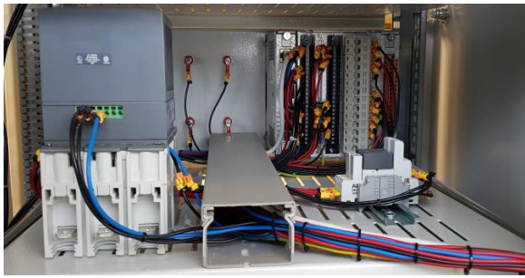
Rys. 4. Urządzenia tworzące stanowisko badawcze [3]
