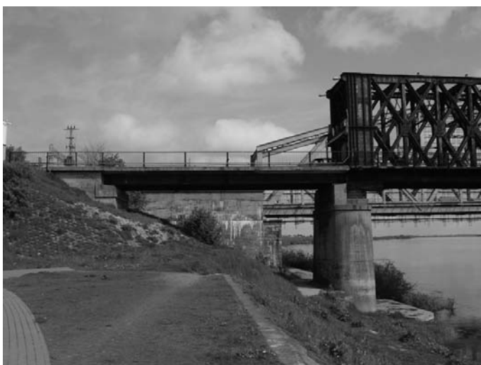
Rys. 4. Fotografia przedstawia stan obecny wjazdu na most, gdzie pierwotnie znajdowały się bramy portalowe (fotografia własna)
