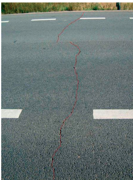
Fot. 1. Nieregularne spękanie poprzeczne wywołane podbudową z mieszanki MCE
