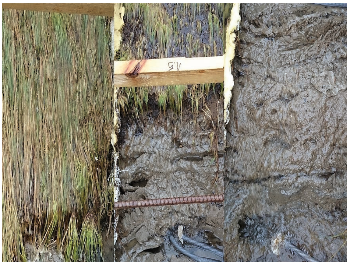
Rys. 7. Degradacja okrywy roślinnej na kanale 1, w sekcjach 4 i 5.
