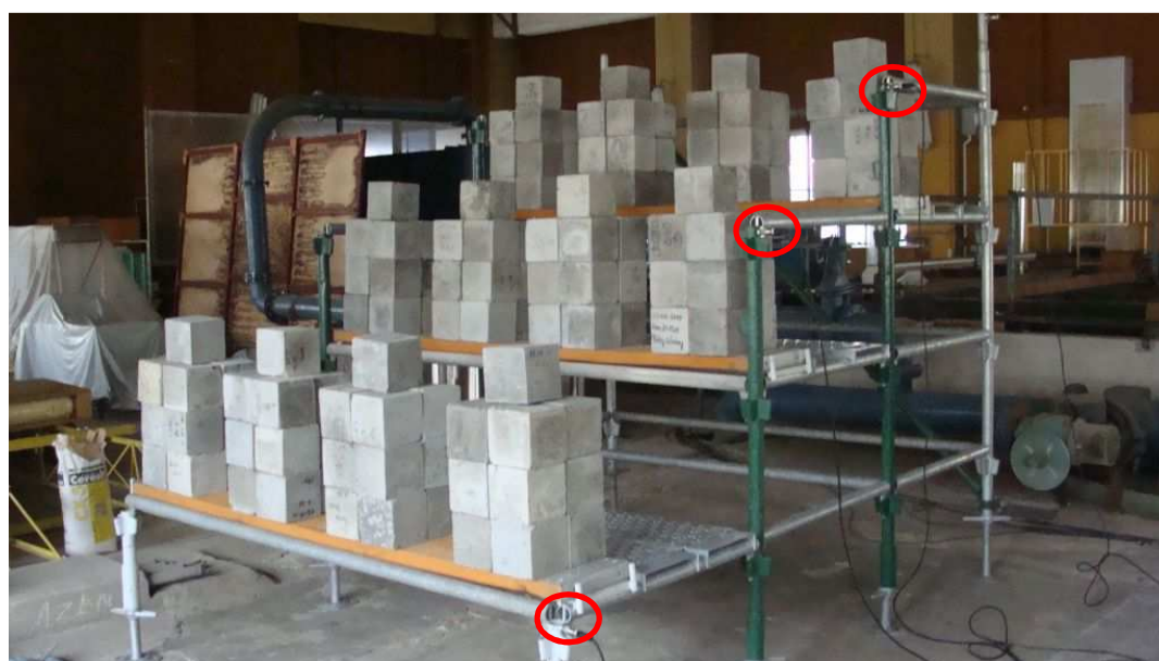
Fot. 5.3 Obciążona tymczasowa trybuna stalowa (widok z boku).
