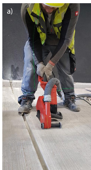
Rys. 10. Etapy naprawy dylatacji konstrukcyjnej: a) trasowanie bruzdy, b) wycięcie i wykucie bruzdy, c) pogłębienie i oczyszczenie bruzdy [26]
