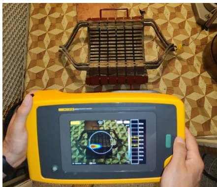
Rys. 4. Przykład lokalizacji koncentracji WNZ kamerą akustyczną Fluke ii900 dla oryginalnego eksploatowanego uzwojenia
