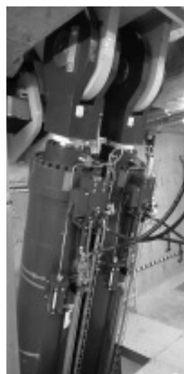
Fot. 2. Dźwigniki hydrauliczne (kładka w pozycji otwartej)
