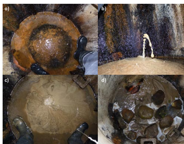
Rys. 12. Studnia z zakolmatowaną geowłókniną: a) stan zastany, b) wypływ wody przez rozdarcie, c) upłynienie podłoża pod studnią, d) doraźne zabezpieczenie przed wynoszeniem podłoża
