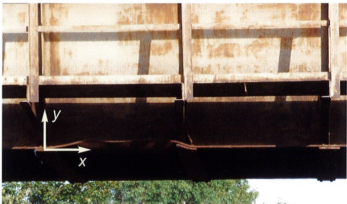
Deformacje pionowe krawędzi pasa dolnego
