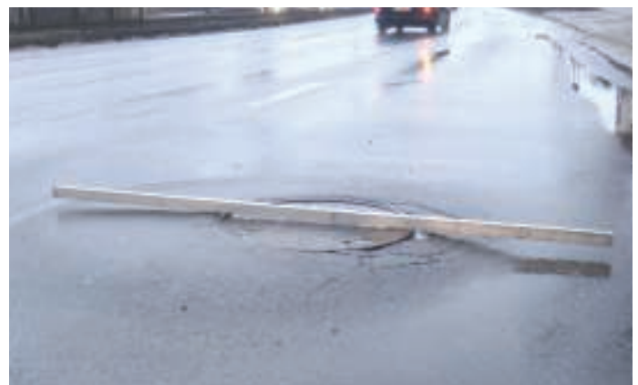
2. Przykład wyniesienia studni kanalizacyjnej powyżej sąsiadującej z nią konstrukcji nawierzchni na odcinku ulicy Podwale Przedmiejskie w Gdańsku
