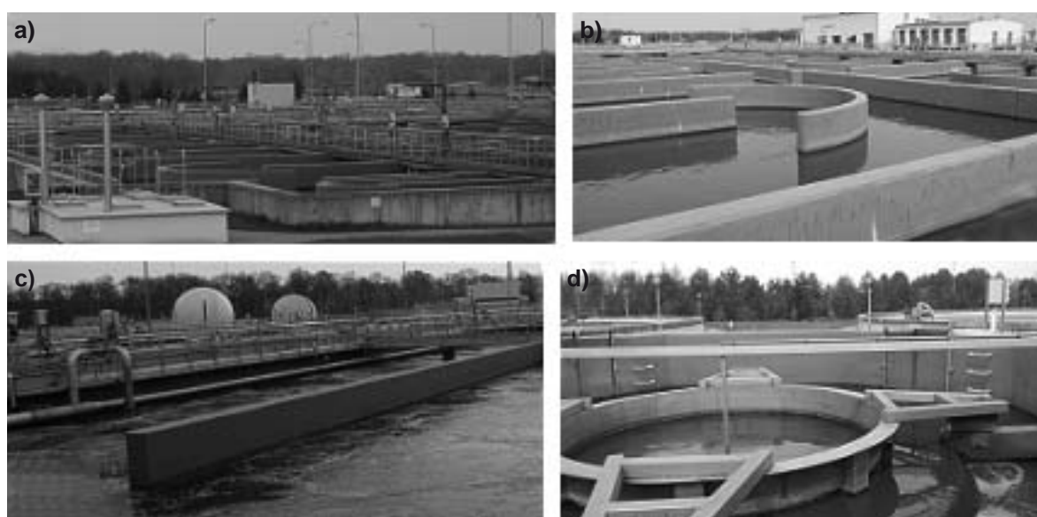
Rys. 8. Linia ściekowa a) mieszacze, b) aktualnie eksploatowana komora mieszania, c) napowietrzanie, d) osadnik radialny ( D = 48\text{ m} )
