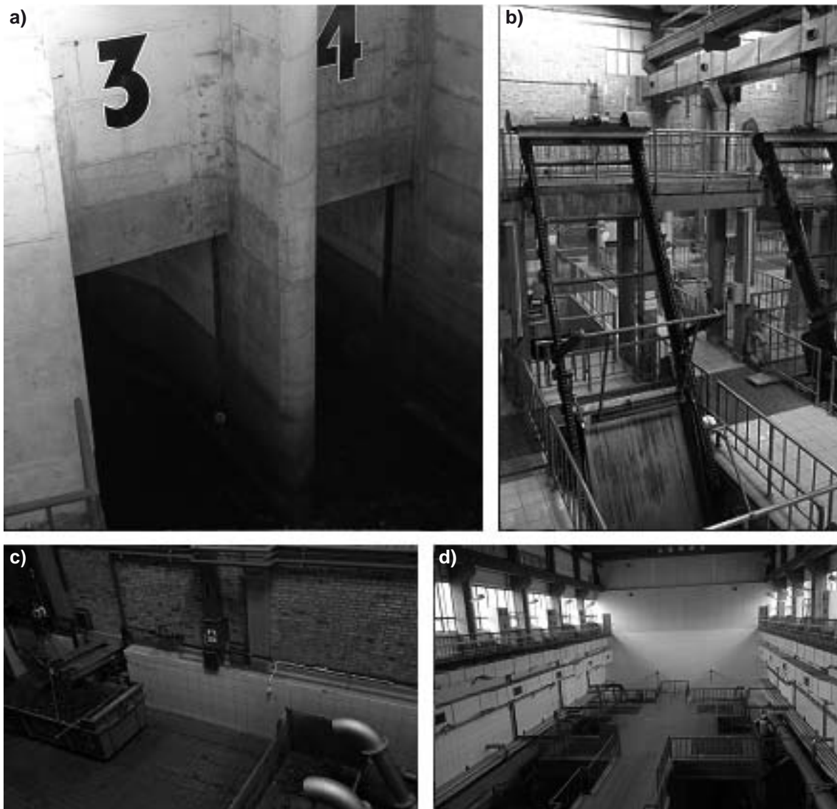
Rys. 7. Początek ciągu technologicznego a) komora rozdziału (włączony ciąg nr 3 i nr 4), b) kraty, c) skratki, d) przepompownia ścieków surowych
