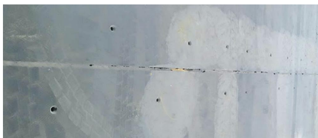
Rys. 10. Betonowa posadzka przemysłowa (przykład 2) podczas naprawy: plan nawierconych otworów do podawania iniekcji
