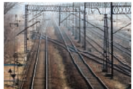
2. Poszerzenie o małej wartości na trójmiejskiej linii SKM w torze 501 między przystankami Gdańsk-Wrzeszcz i Gdańsk-Zaspa. Źródło: fotografia własna
