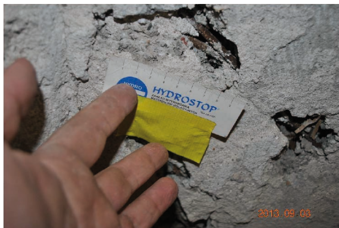
Rys. 9. Ubytki betonu i skorodowane zbrojenie powłoki kopuły w obszarze naroża północno-wschodniego [6]
