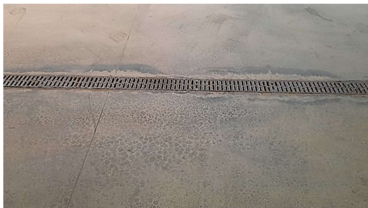
Rys. 8.10. Nieudana, kolejna próba utwardzenia powierzchniowej płyty fundamentowej (fot. S. Świątek-Żołyńska)
