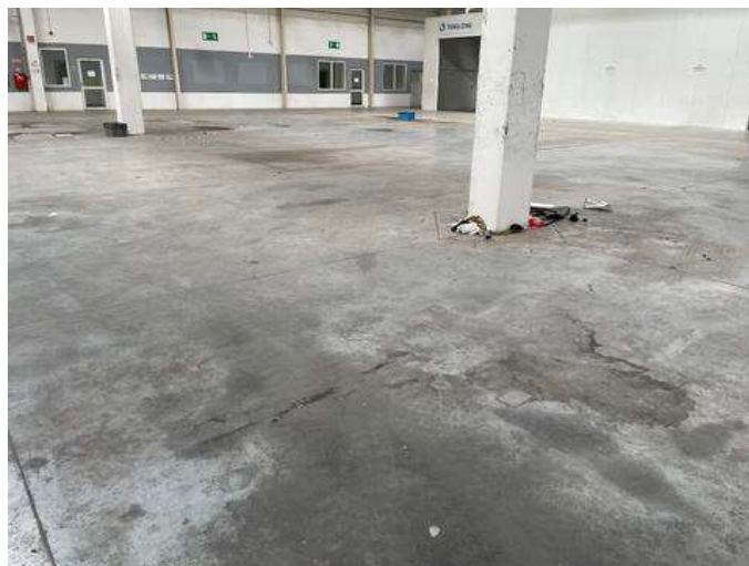
Rys. 10.13. Betonowa posadzka przemysłowa (Przykład 4) przed renowacją: uszkodzona górna powierzchnia posadzki na skutek nieprawidłowego zastosowania środków czyszczących [M1]
