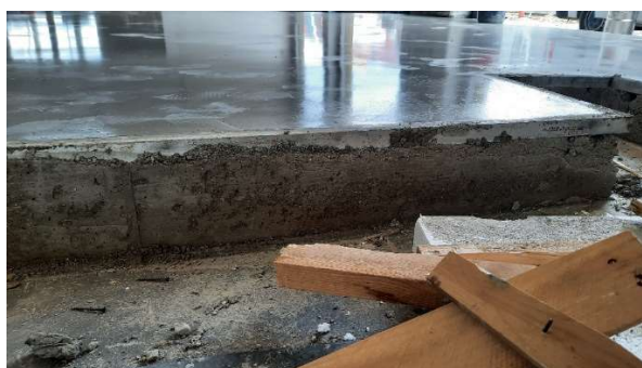
Rys. 8.16. Uszkodzenia płyty posadzkowej będące konsekwencją nieprawidłowej konsystencji mieszanki betonowej i brakiem możliwości jej prawidłowego zagęszczenia (fot. S. Świątek-Żołyńska)
