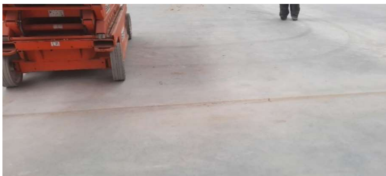
Rys. 8.18. Brak zabezpieczenia na etapie dojrzewania posadzki (fot. S. Świątek-Żołyńska)
