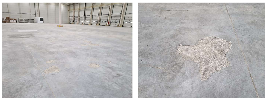
Rys. 8.11. Uszkodzenia powstałe w wyniku braku mieszania mieszanki betonowej podczas transportu w betonowozie (fot. S. Świątek-Żołyńska)
