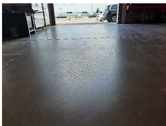
Rys. 8.8. Zniszczenie filmu cementowego w licu posadzki w strefie z nawożoną solą drogową (fot. S. Świątek-Żołyńska)
