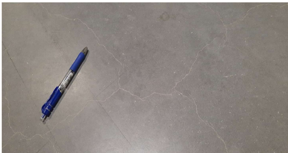
Rys. 8.1. Pęknięcia betonowej posadzki przemysłowej w wyniku braku zaprojektowania dylatacji skurczowych (fot. S. Świątek-Żołyńska)
