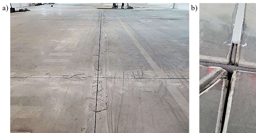
Rys. 10.17. Betonowa posadzka przemysłowa (Przykład 4) podczas naprawy: a) usuwanie zdegradowanego wypełnienia dylatacji skurczowych, b) ułożenie nowego wypełnienia dylatacji skurczowych [M1]
