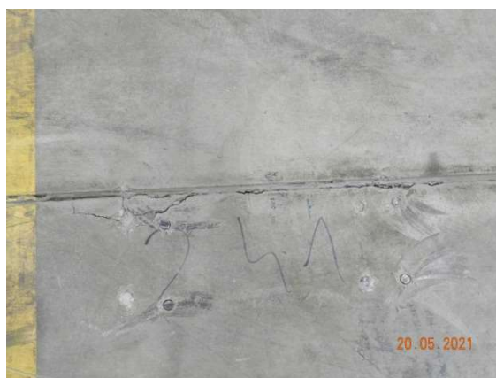
Rys. 8.5. Zniszczenia posadzki w wyniku zamontowania kotew w strefie przydylatacyjnej ( fol. S. Świątek-Żołyńska )
