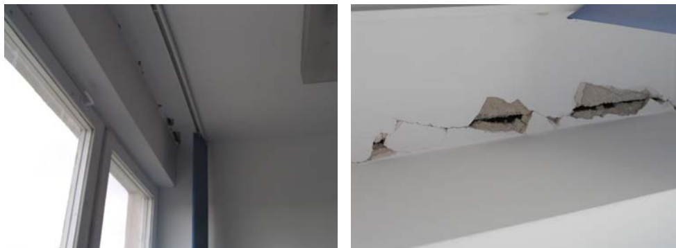
Ryc. 6. Suwałki, Centrum Edukacji Nauczycieli, ul. Reja, charakterystyczne pęknięcia tynku pomiędzy stropem a nadprożem okiennym
