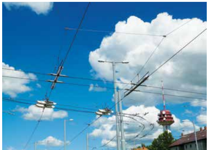
Fot. 3. Szybkoprzejezdne skrzyżowanie trolejbusowej i tramwajowej sieci trakcyjnej, Szeged, Węgry. Fot. M. Bartłomiejczyk
