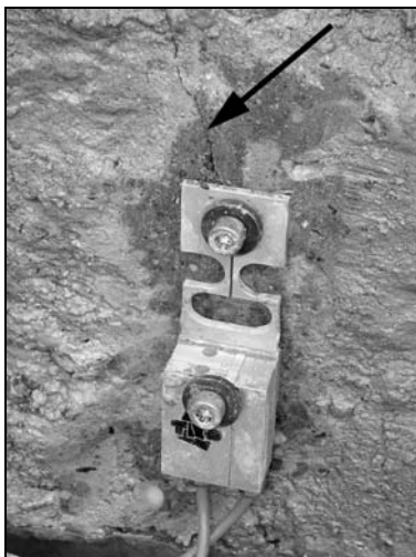
Rys. 6. Pęknięcie głowicy pala w czasie badania dynamicznego
