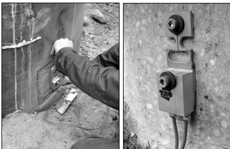
Rys. 4. Czujniki zamontowane na palu
