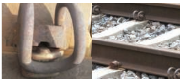
6. Uszkodzona wkładka WKW [9] Rys. 7. Brak przytwierdzenia SB [9]
