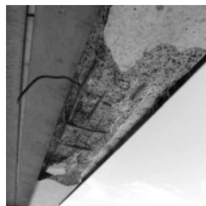
Fot. 1. Ubytki w dźwigarze skrajnym Photo 1. The losses in utmost girder
