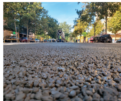
Fot. 1. Beton jamisty
