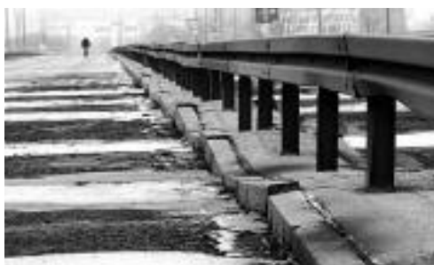
Fot. 1. Pomost uszkodzony w wyniku pożaru [Fot. Sławomir Kamiński/Agencja Gazeta] Photo 1. Damaged decks as a result of fire [Photo Sławomir Kamiński/Agencja Gazeta]
